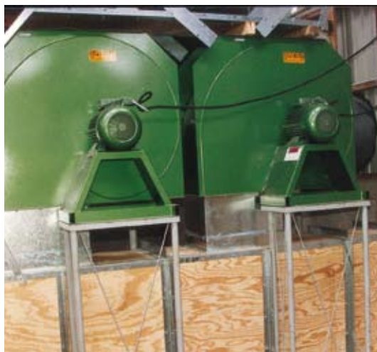
To blæsere monteret på samme hovedkanal
